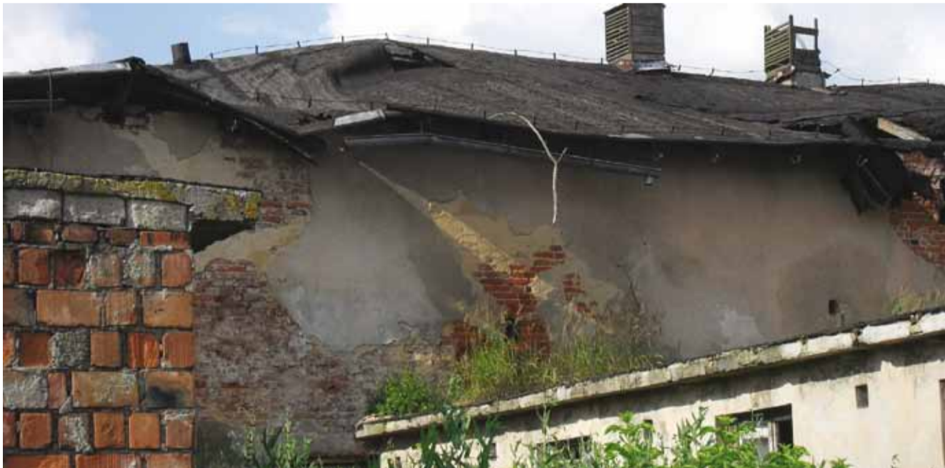
Budynki znajdowały się w katastrofalnym stanie technicznym, nadawały się tylko do wyburzenia.
